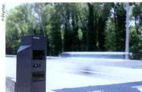
Le système de comptage installé sur l'A48, au niveau de Grenoble.
